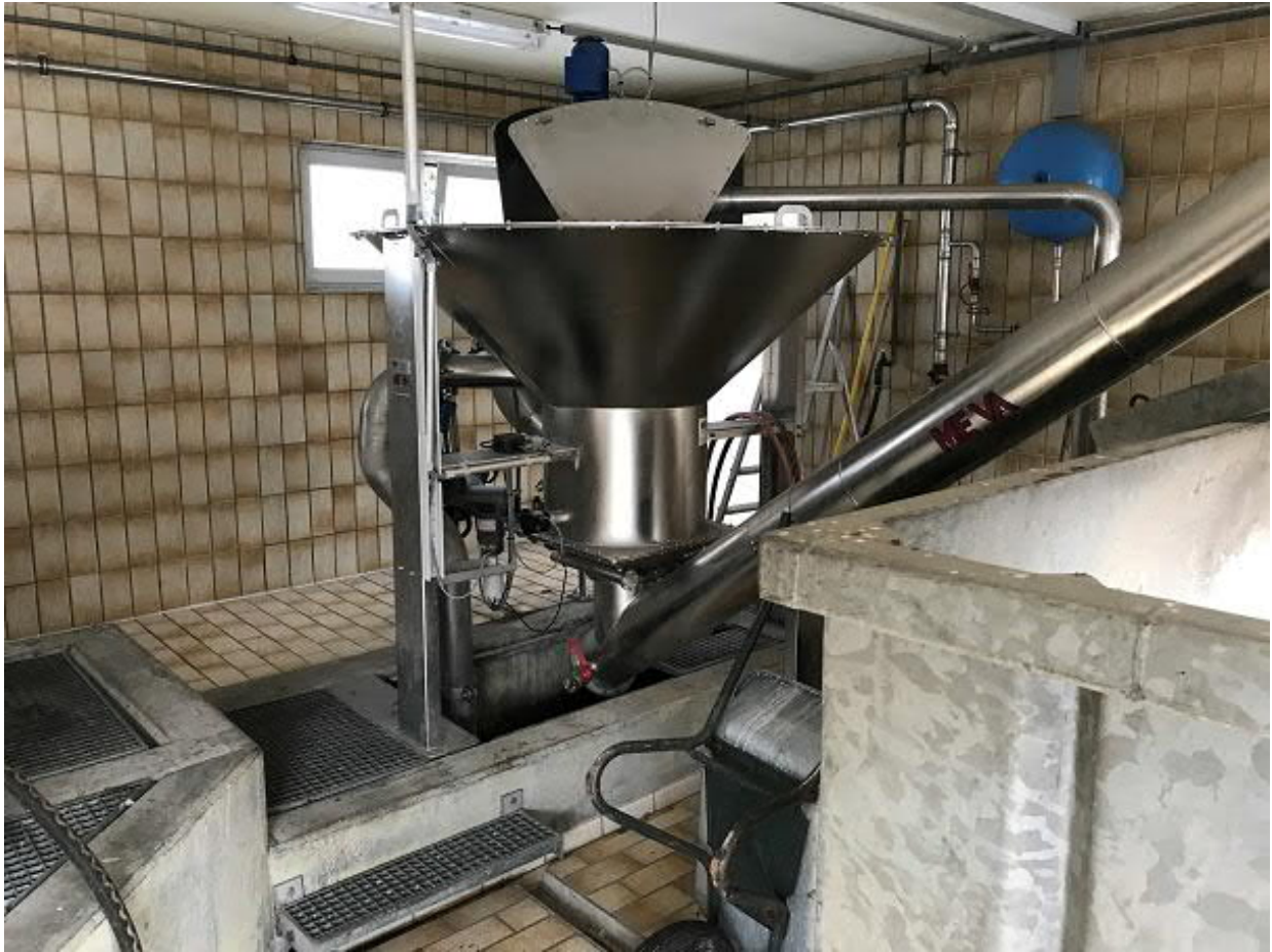
Abbildung 24: Sandwaschanlage Kläranlage Göggingen-Horn (Weißert 2020)
