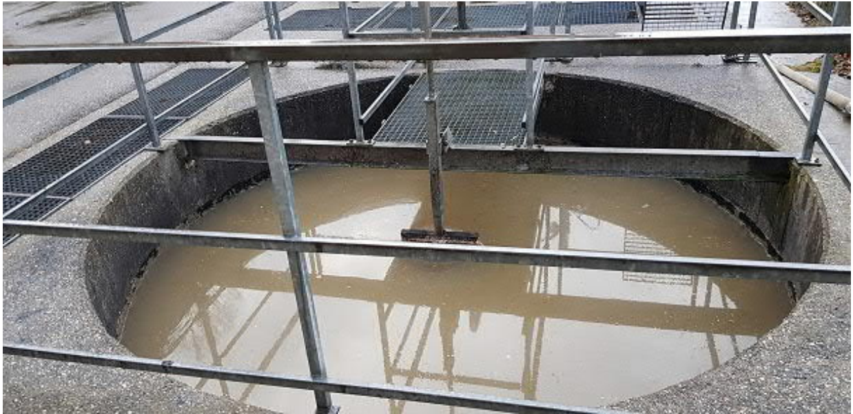
Abbildung 6: Fettfang Kläranlage Schechingen (Weißert 2022)
