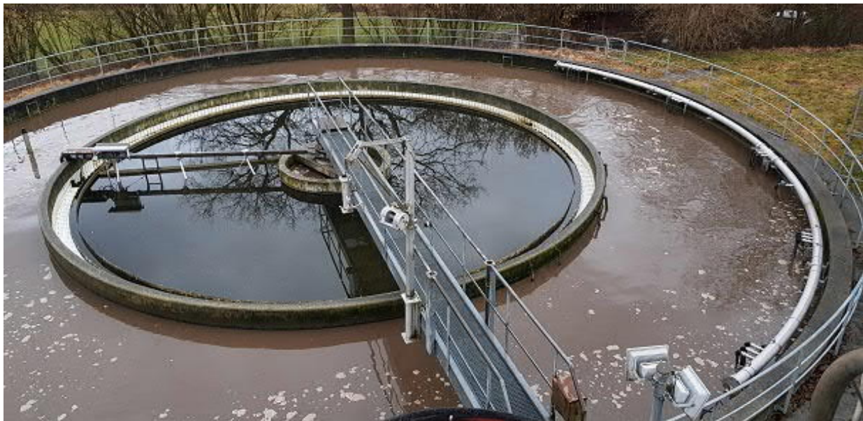
Abbildung 7: Belebungsbecken mit innen liegenden Nachklärbecken Kläranlage Schechingen (Weißert 2022)
