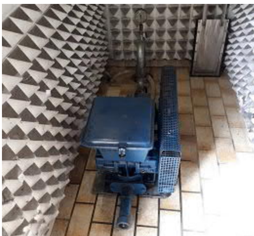
Abbildung 26: Sandfanggebläse Kläranlage Göggingen-Horn (Weißert 2020)
