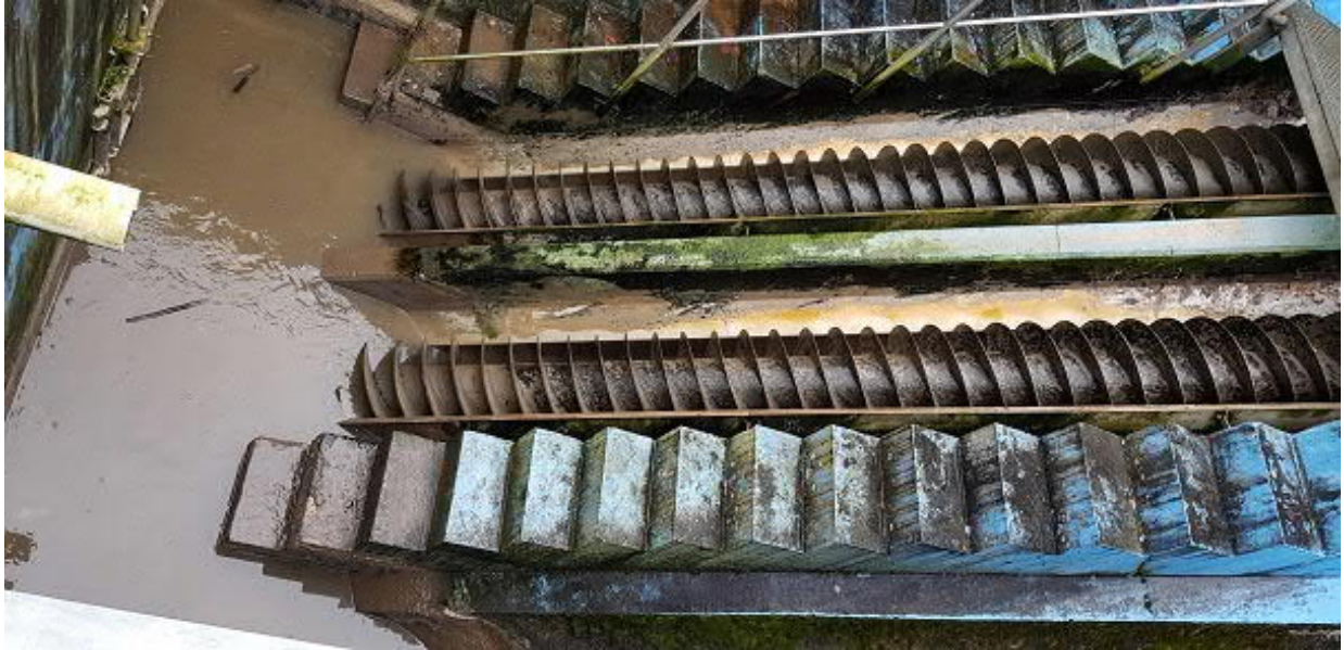
Abbildung 13: Schneckenpumpwerk Zulauf Kläranlage Heuchlingen (Weißert 2022)
