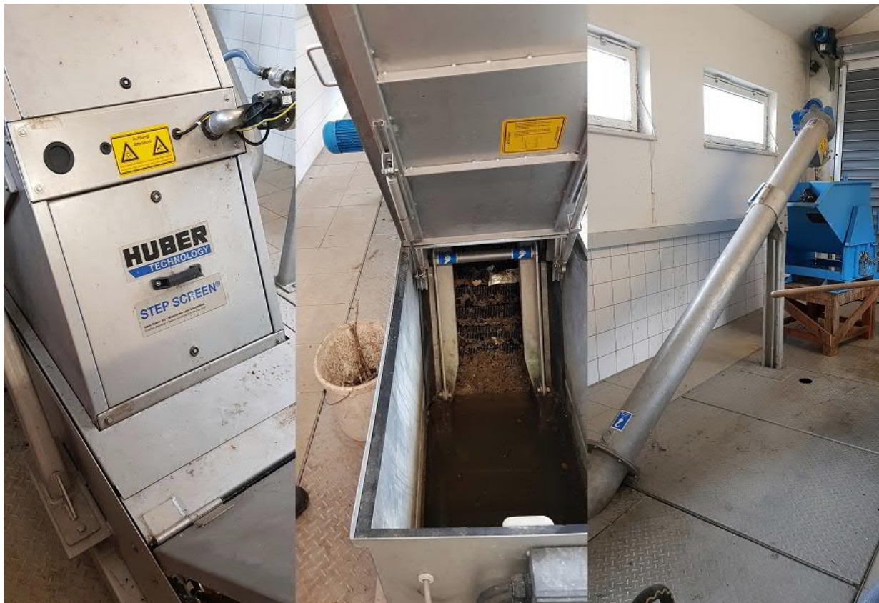
Abbildung 14: Rechenanlage und Austrag Kompakt-Sandfang Kläranlage Heuchlingen (Weißert 2022)
