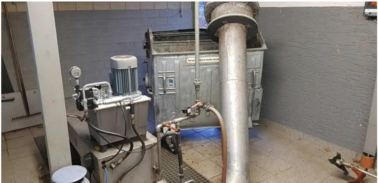
Abbildung 5: Rechenanlage Kläranlage Schechingen (Weißert 2022)
