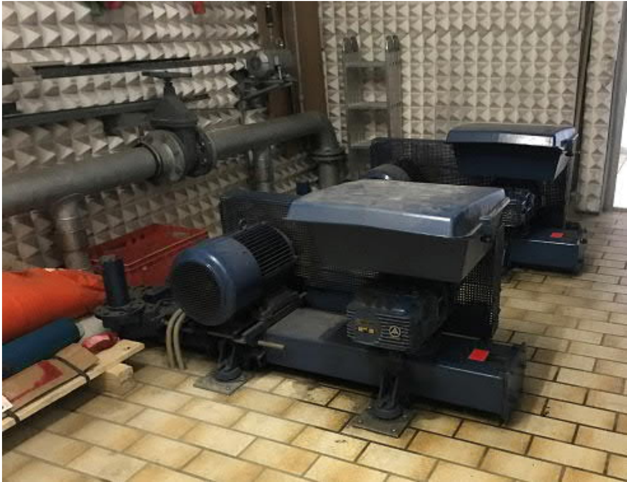
Abbildung 29: Gebläse Kläranlage Göggingen-Horn (Weißert, 2020)
