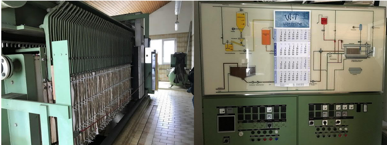
Abbildung 31: Kammerfilterpresse Kläranlage Göggingen-Horn (Weißert, 2020)
