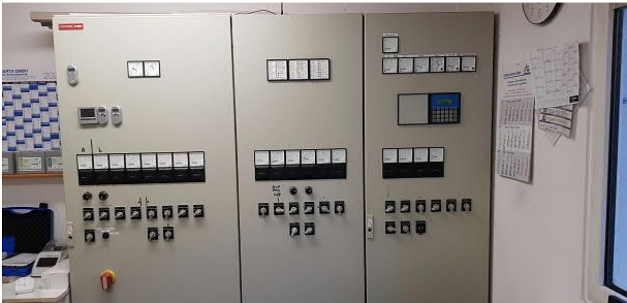
Abbildung 10: Schaltwarte Kläranlage Schechingen (Weißert 2022)
