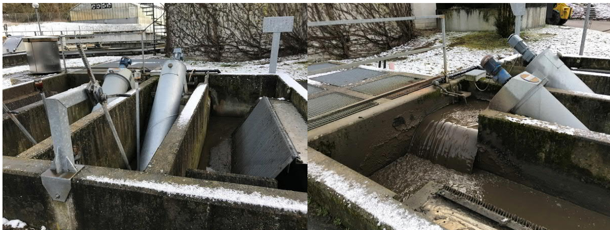
Abbildung 28: Rücklaufschlammförderung mit Stabrechen Kläranlage Göggingen-Horn (Weißert, 2020)
