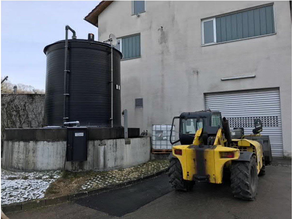
Abbildung 30: P-Elimination Fällmittelbehälter Kläranlage Göggingen-Horn (Weißert, 2020)
