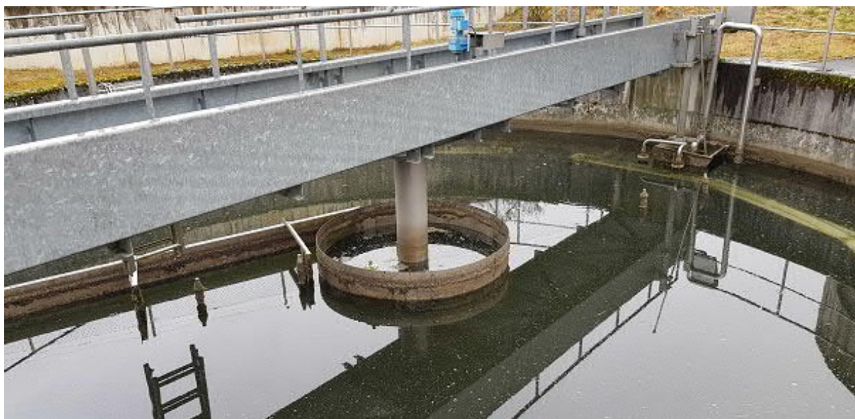
Abbildung 16: Nachklärbecken der Kläranlage Heuchlingen mit Räumern (Weißert 2022)
