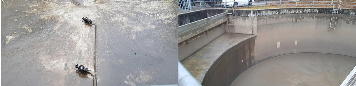
Abbildung 3: RÜB 1, Rührwerke, RÜB 2 der Kläranlage Schechingen (Weißert 2022)
