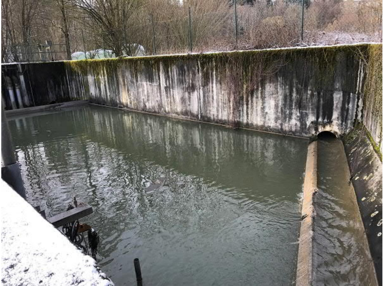
Abbildung 22: RÜB Kläranlage der Kläranlage Göggingen-Horn (Weißert 2020)
