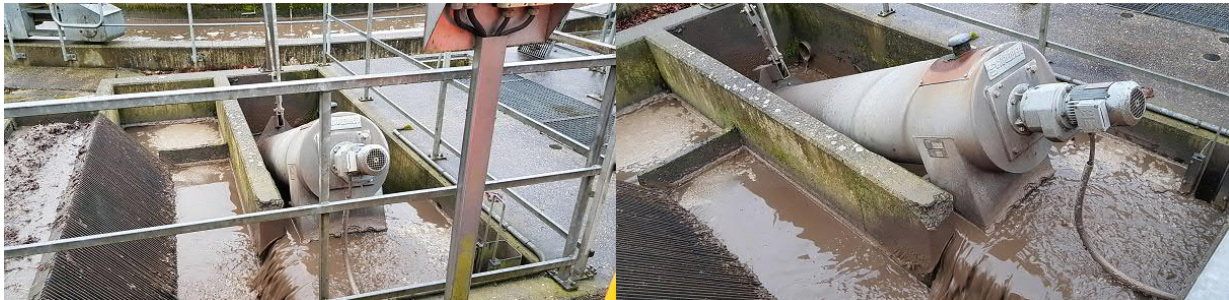
Abbildung 8: Rücklaufschlammförderung mit Stabrechen Kläranlage Schechingen (Weißert, 2022)
