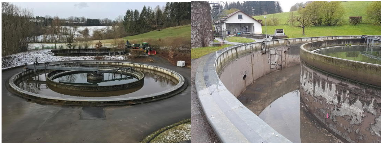
Abbildung 27: Belebungsbecken 2 mit innen liegenden Nachklärbecken Kläranlage Göggingen-Horn (Weißert 2020) Belebungsbecken 1, teilentleert (LK&P 2017)
