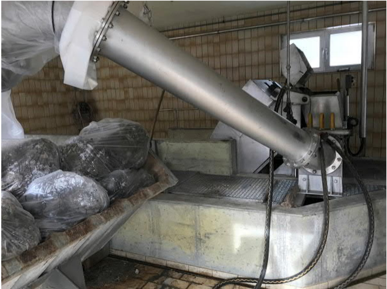
Abbildung 23: Rechenanlage Kläranlage Göggingen-Horn (Weißert 2020)
