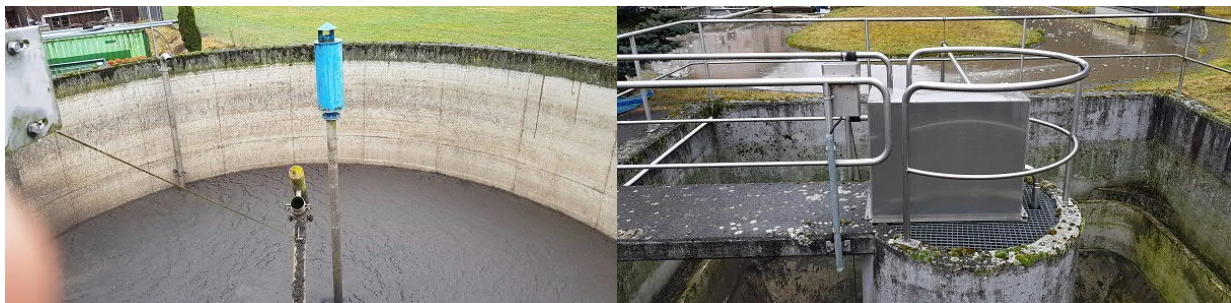
Abbildung 17: Schlamm-silo und Filtratspeicher der Kläranlage Heuchlingen (Weißert 2022)
