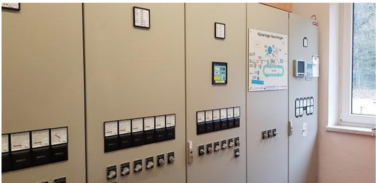
Abbildung 18: Schaltwarte mit elektronischer Schaltanlage der Kläranlage Heuchlingen (Weißert 2022)
