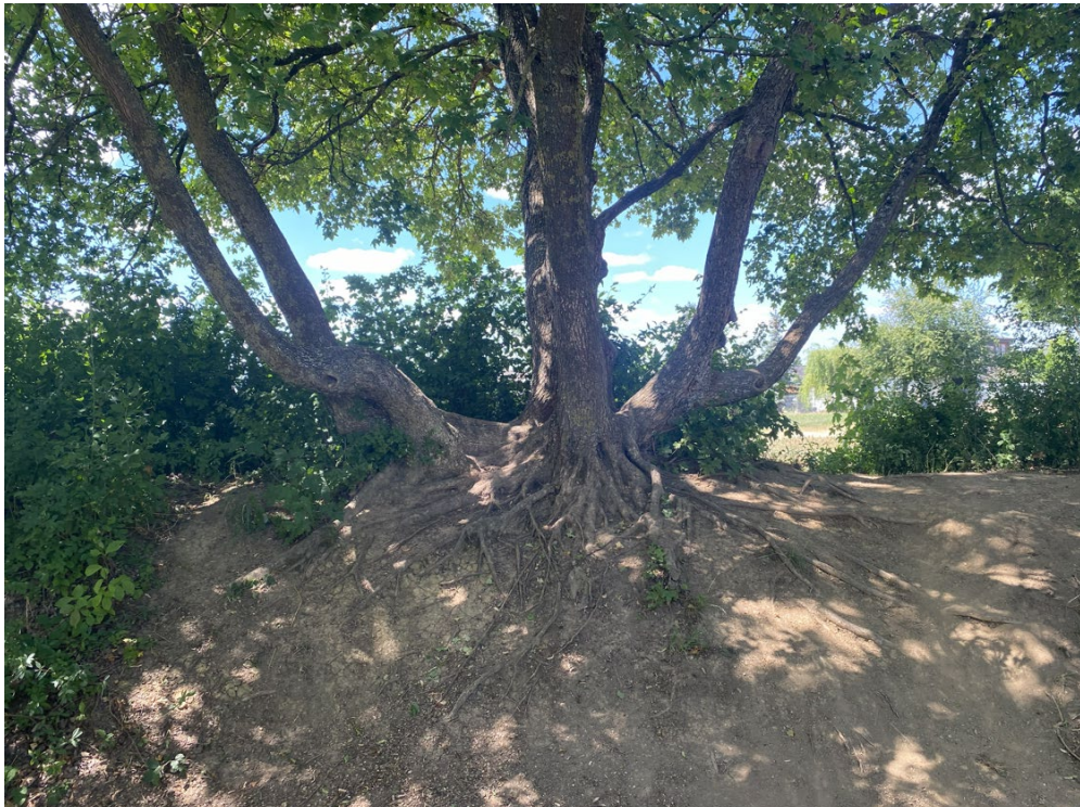
Böschungsabtrag durch intensive Nutzung
