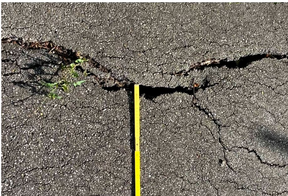
Rißbildungen im Asphaltbelag
