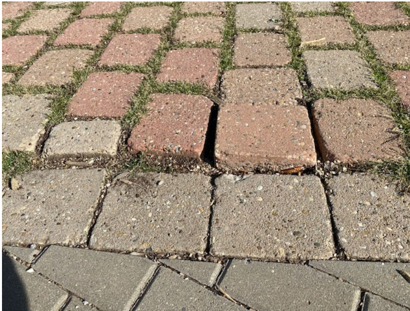
Gelockerte Pflastersteine in Pflasterbelagsflächen
